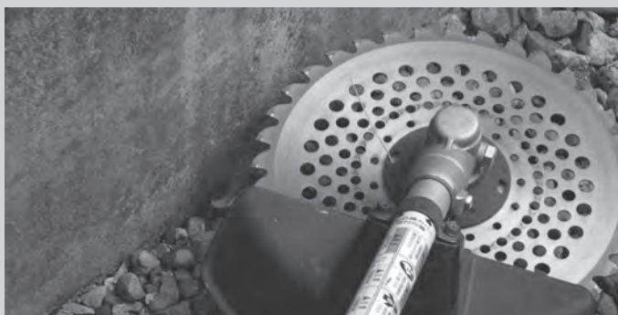
壁際での機械使用（使用方法違反）は厳禁！
